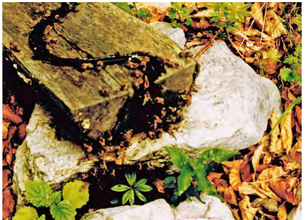
Ein Regenwasser-Sammelfass versorgt über eine Regelung durch ein Nadelventil eine Wasserrinne in einem Holzbalken.
