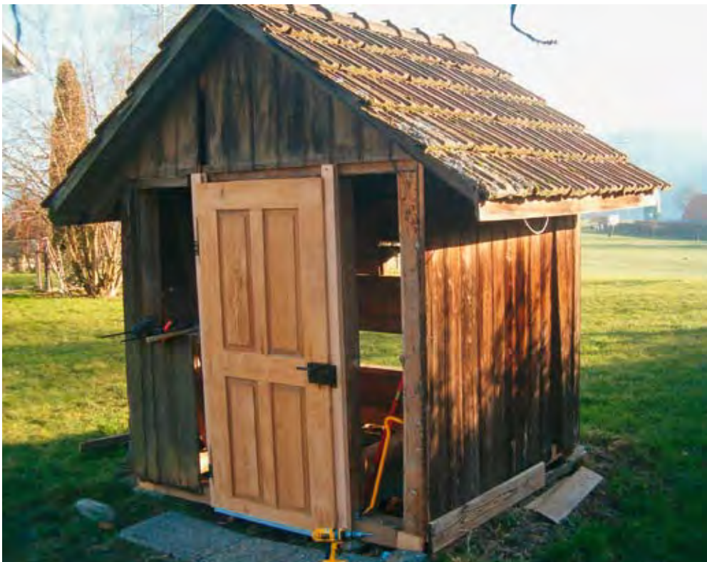
Mitten im grossen Umbau: Ausser dem Dach musste praktisch alles ersetzt werden.
