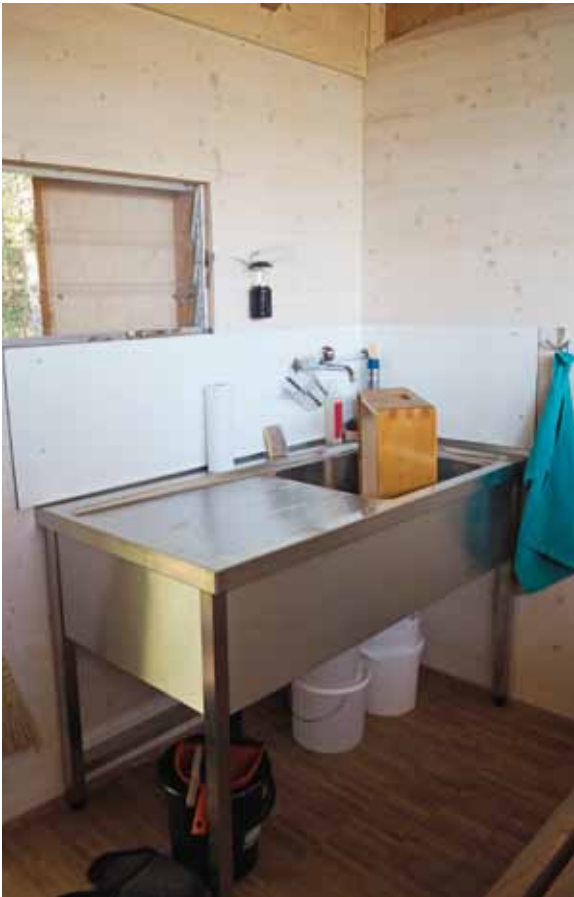
Grosser Waschtrog. Dachwasser wird aussen in einem Tank aufgefangen und zum Wasserhahn über dem Waschtrog geleitet.
