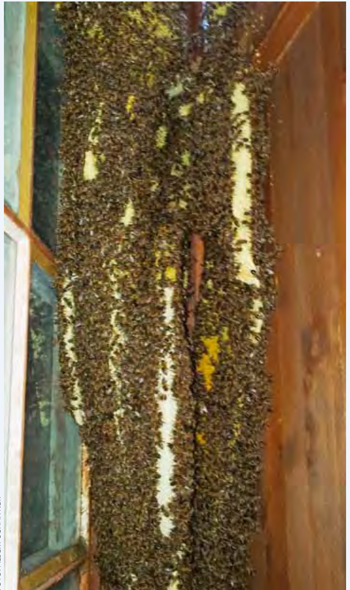
Zwischen Fensterladen und Fenster hatte der Schwarm ein riesiges Wabengebilde aufgebaut.
