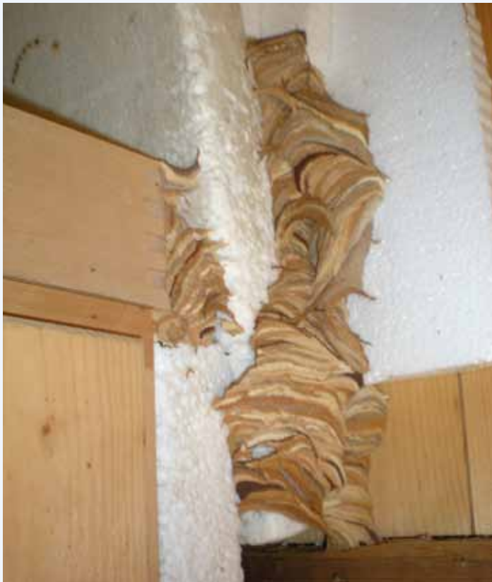
Zwischen diesen beiden Styroporplatten entwickelte sich in relativ kurzer Zeit ein wunderbar gebautes, respektables Hornissennest.
